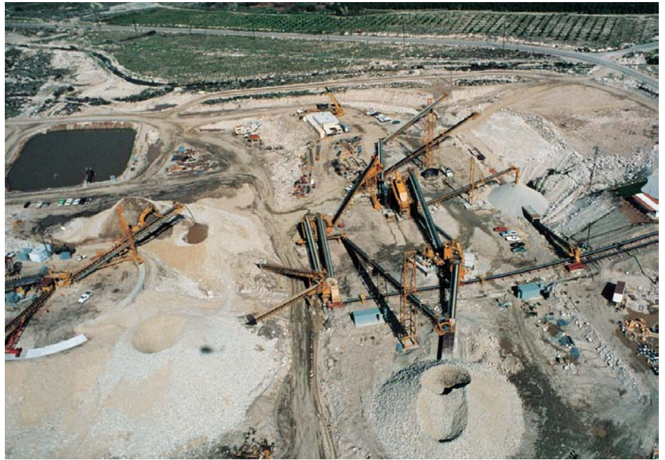
Fig. 5: Central de britagem e processamento de material
